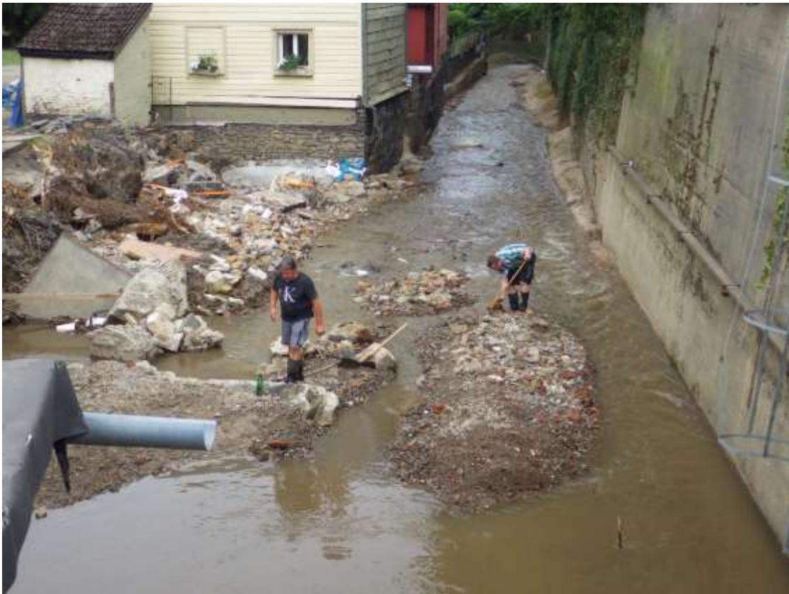
Abb. 7: Nahmer Bach, komplett zerstörte Ufermauer sowie abgetragenes Gartengrundstück (links) 27.07.2021, Foto: J. Drewenskus.
