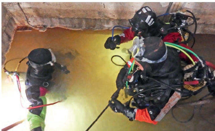
Abb. 3: Erkundung der gefluteten Stollen durch Feuerwehrtaucher; Einstieg im Kellergeschoß; 3. Juli 2020. Foto: Š. Merkač
